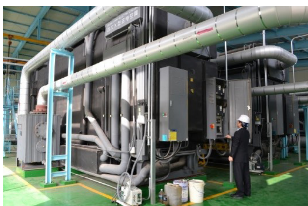
Machine room 机房内部
