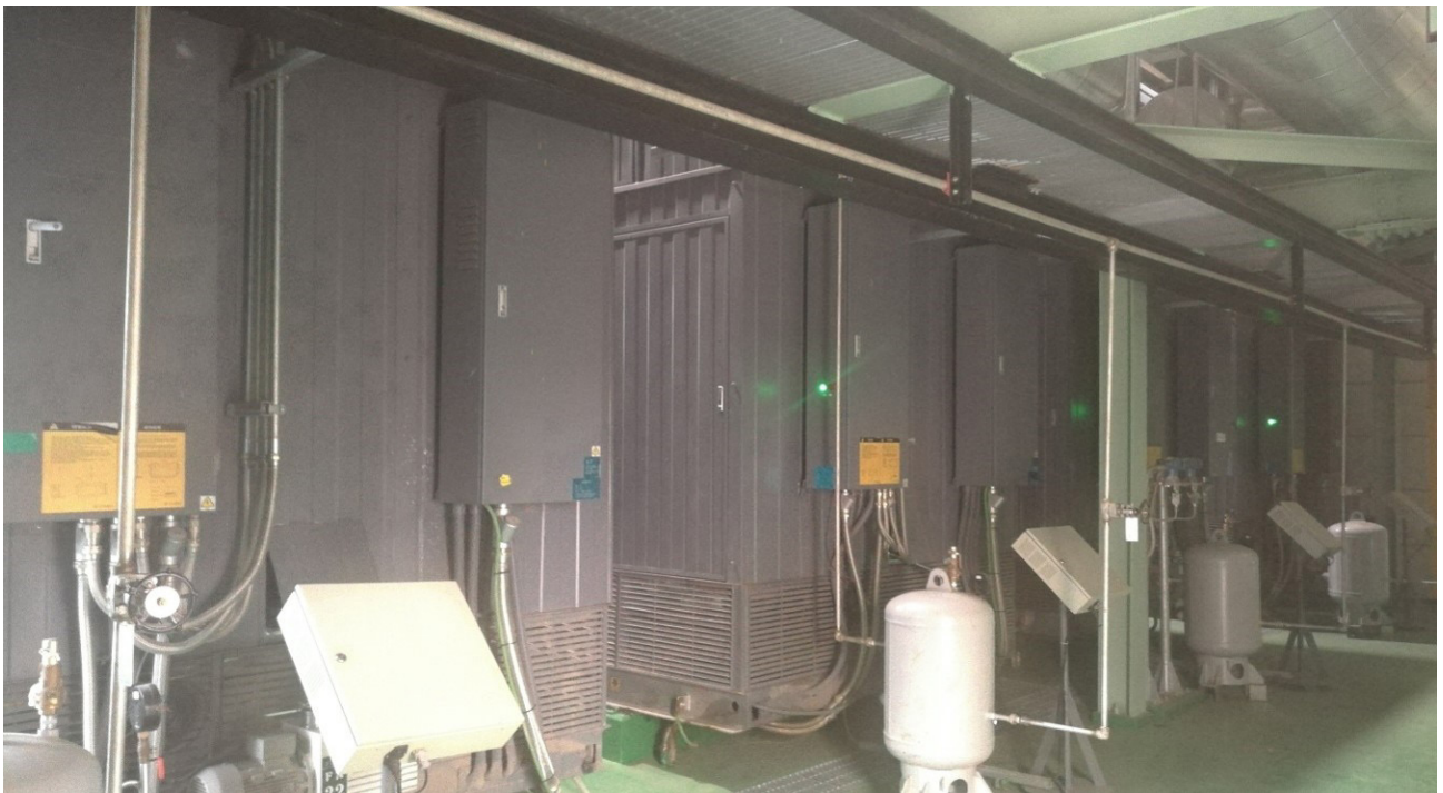
Machine room 热泵机房内部
